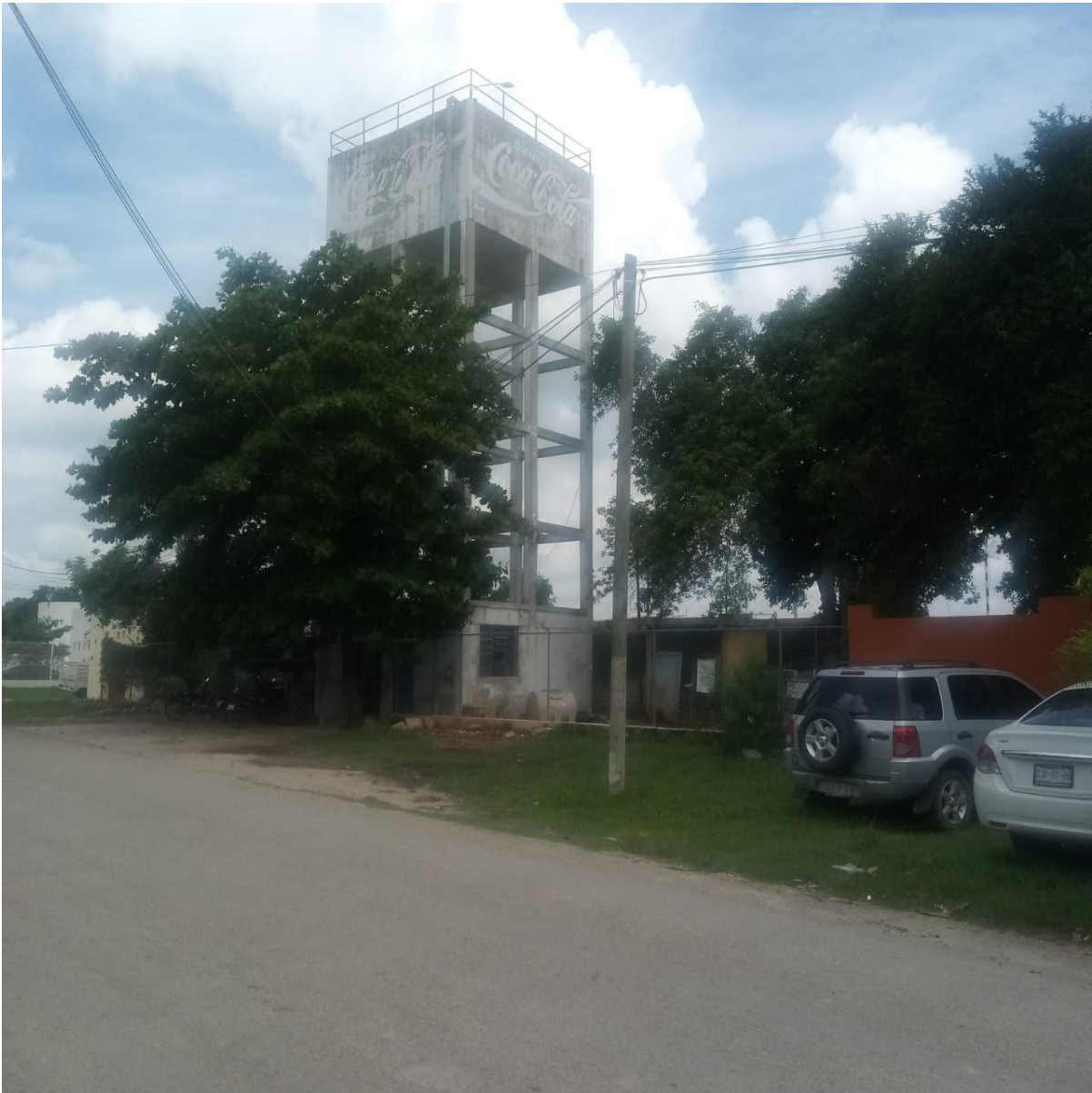
IMAGEN II.4. DEPÓSITO DE DISTRIBUCIÓN DE AGUA POTABLE PARA LA CABECERA MUNICIPAL DE DZITBALCHÉ, CAMPECHE.
